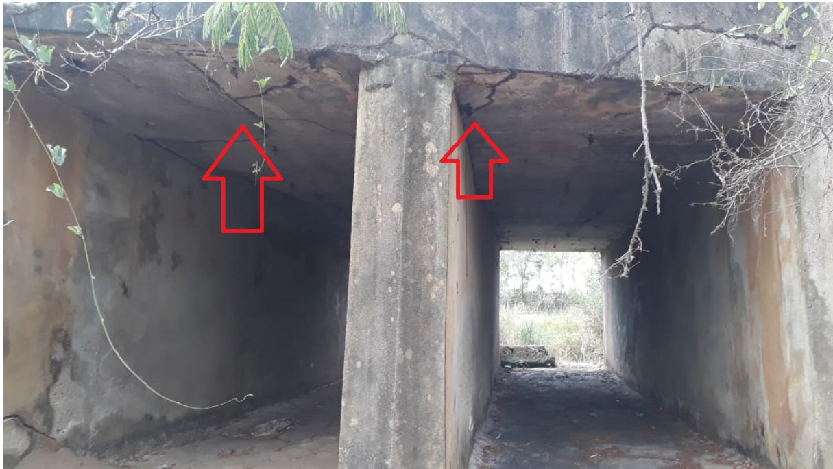
Detalhe da parte inferior da laje com aparição das trincas
