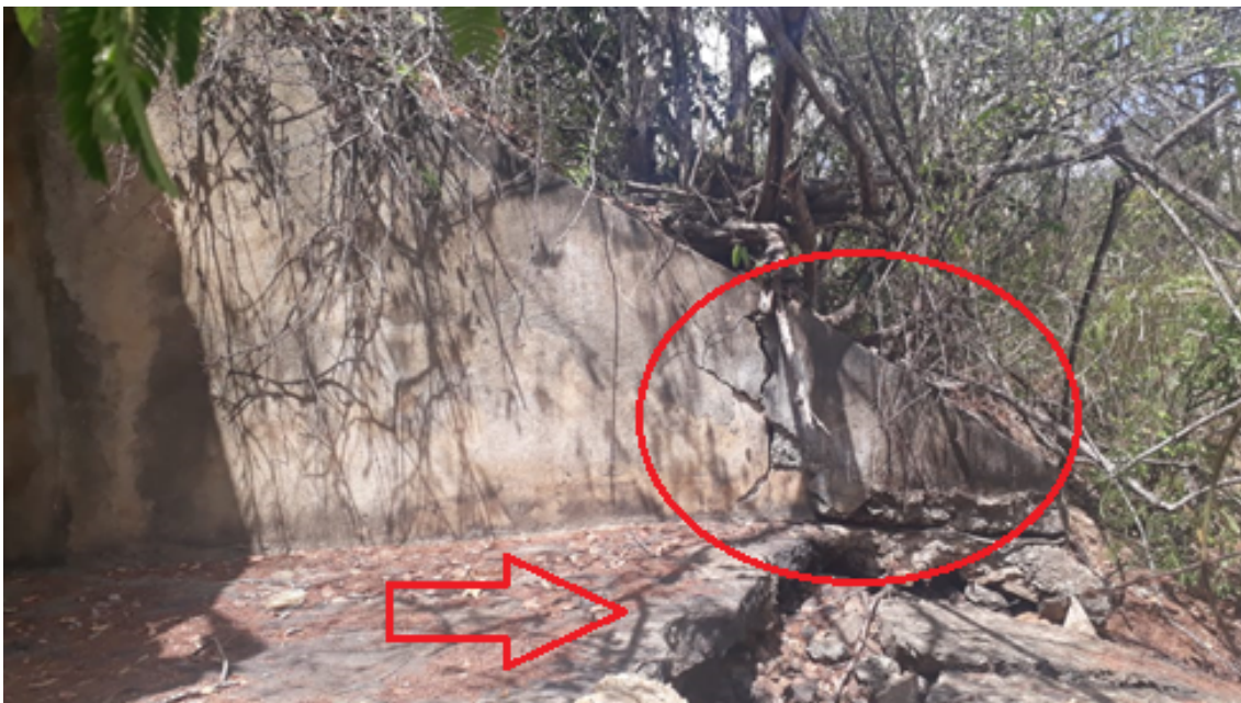
Detalhe do entorno da região de encontro danificado por raízes de árvores
