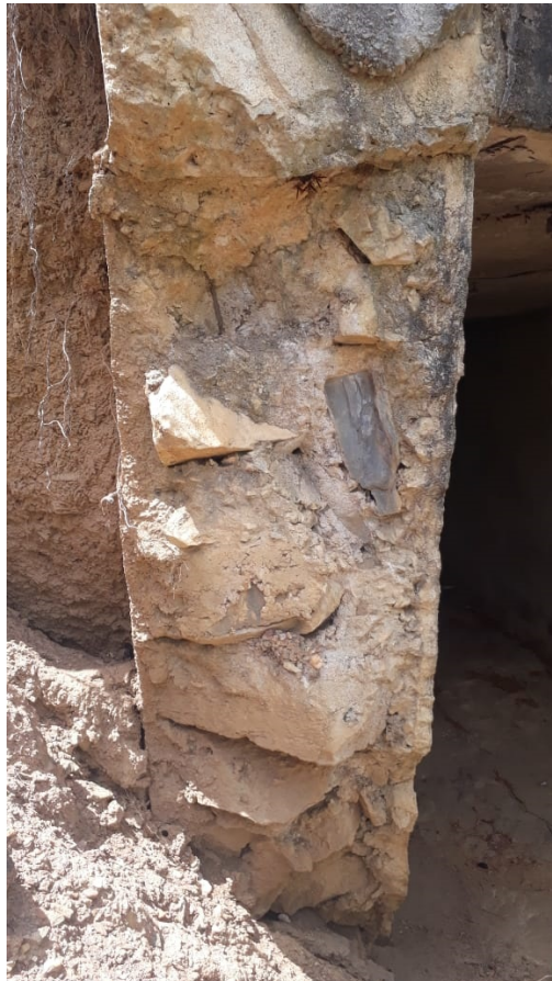
Detalhe do pilar com o agregado graúdo exposto e com vegetação.
