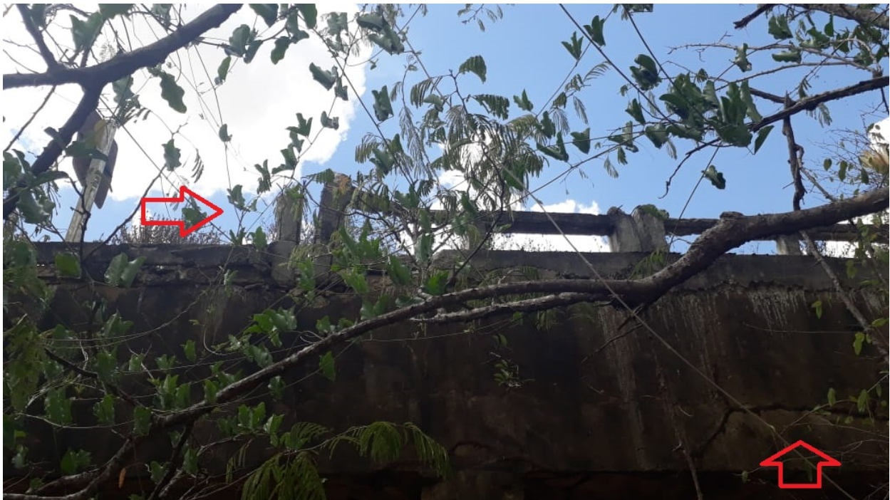
Detalhe da lateral da ponte onde não há guarda corpo com dimensão atendido por norma, vegetação sobre a ponte.
