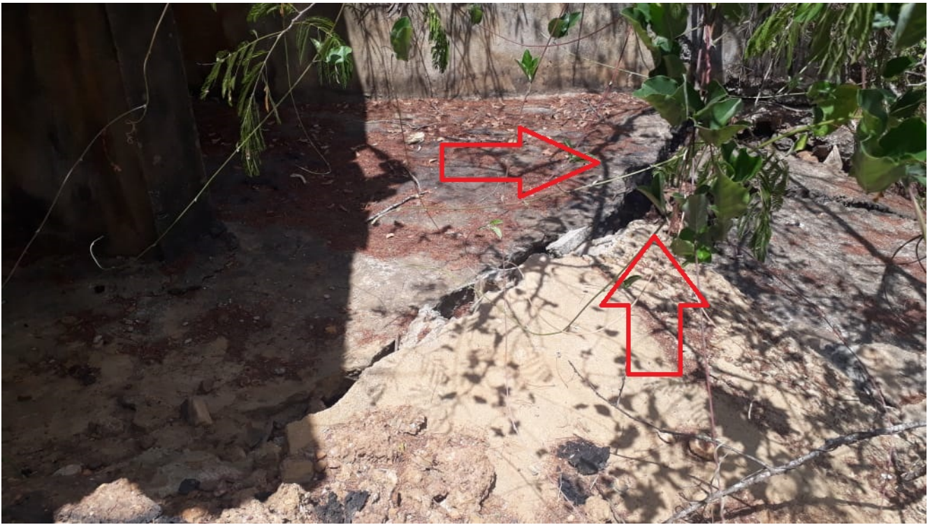
Detalhe da fenda no entorno dos pilares
