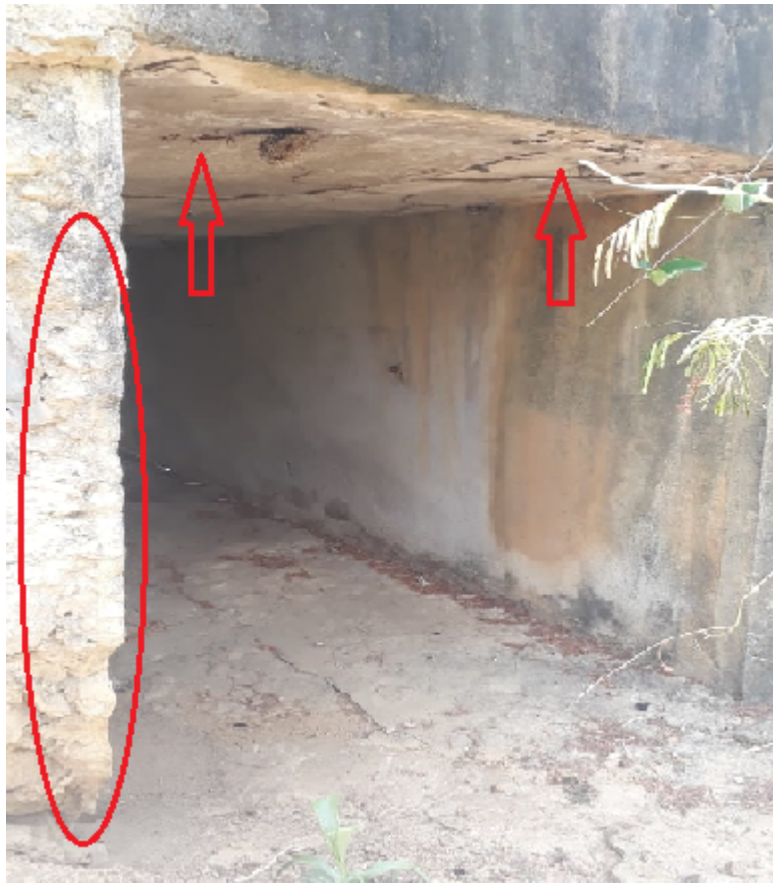
Detalhe agregado graúdo aparente em pilar e rachaduras na região de encontro
