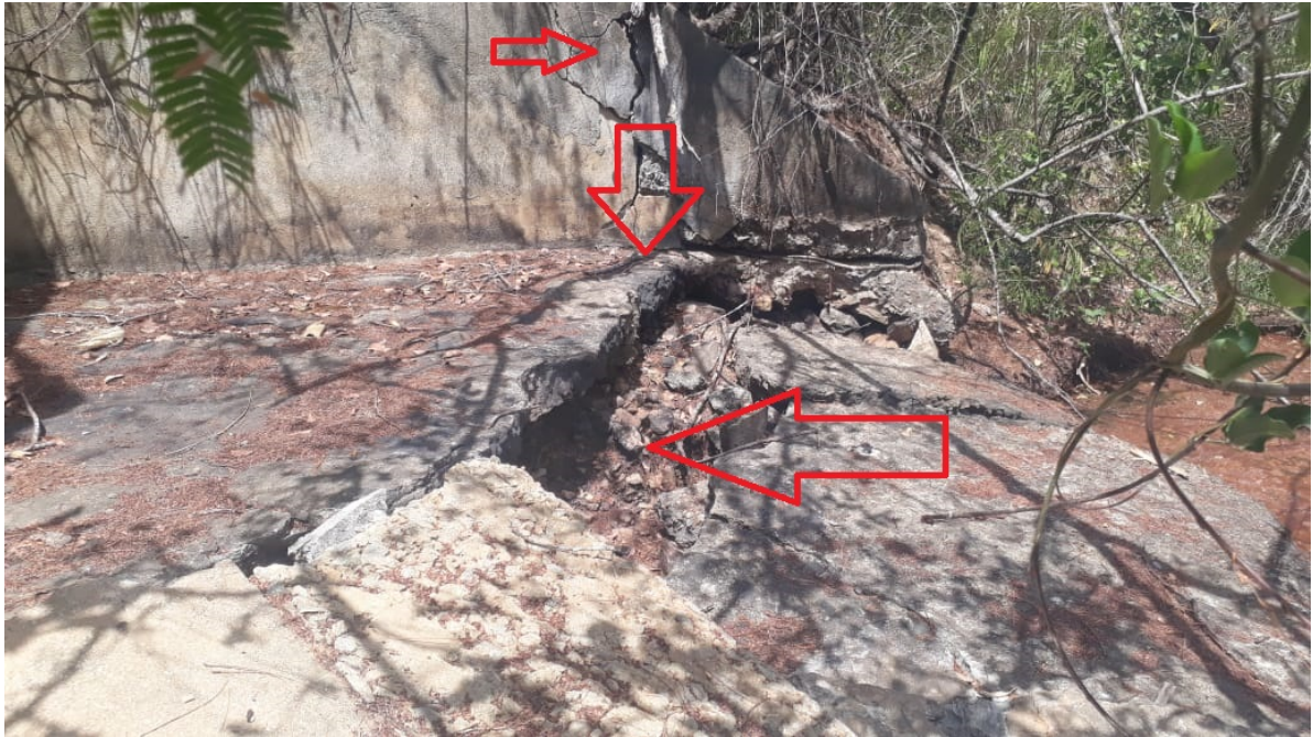
Detalhe das fendas em sua infraestrutura, meio de acesso a agentes nocivos
