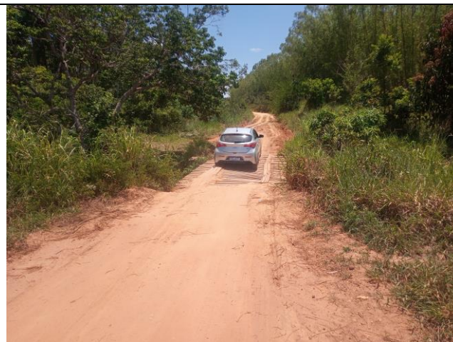
Vista da ponte existente em péssimas condições.
