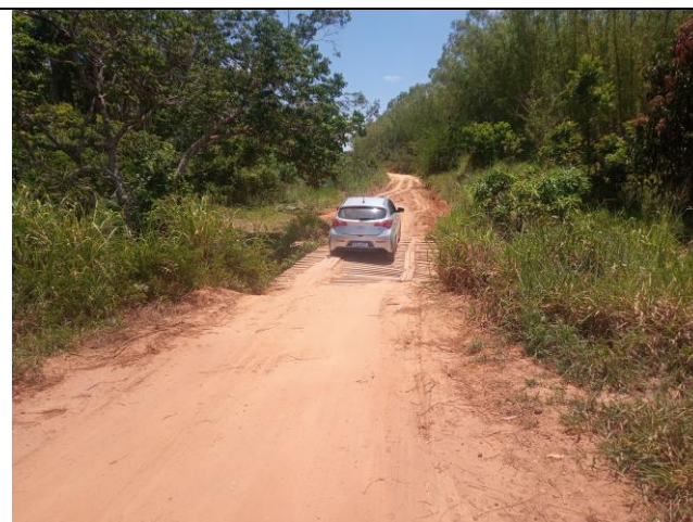
Vista da ponte existente em péssimas condições.
