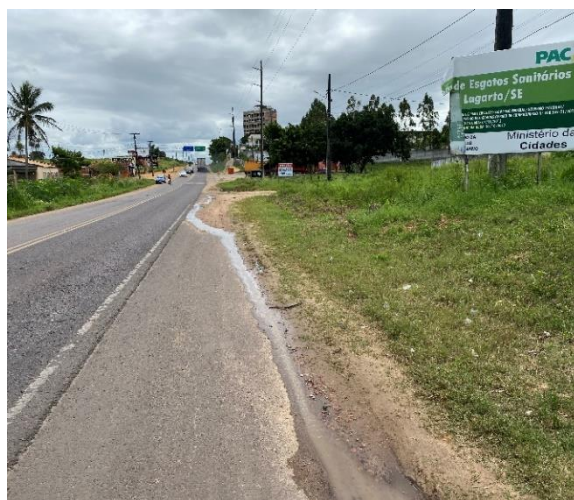
Água acumulada por inadequação do sistema de drenagem.
